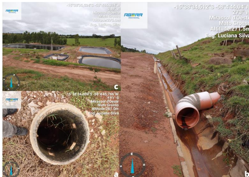
Figura 10 – Sistemas que compõem as células do aterro sanitário: a) Sistema de drenagem do metano; b) Sistema de drenagem do chorume; c) Sistema de recirculação do chorume.
