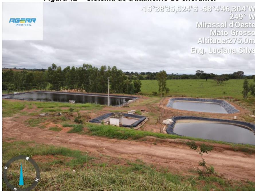
Figura 12 – Sistema de tratamento do chorume.
