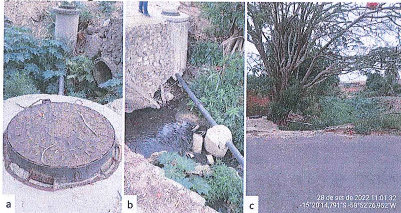
Figura 16: Registro fotográfico da travessia da rede coletora de esgoto sobre o Córrego da Saúde: a) Vista da travessia; b) Vista do PV de montante no qual está ocorrendo o vazamento; c) Vista situacional do Córrego da Saúde.
